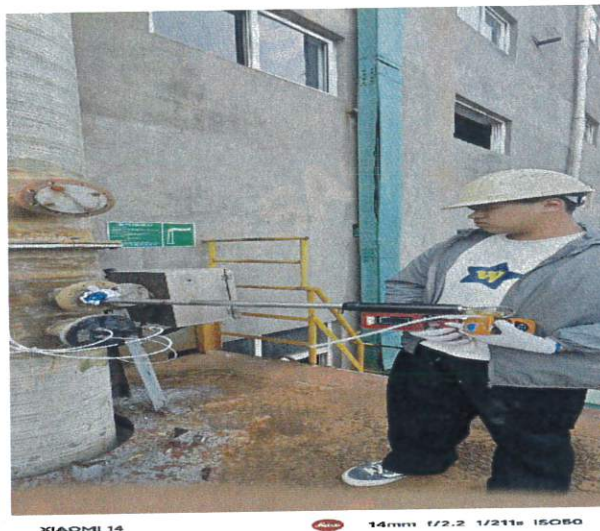
DA031 五车间工艺废气排放口
