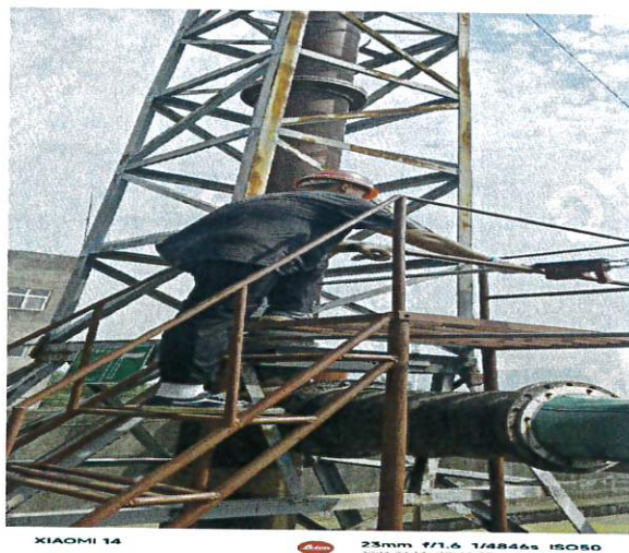
DA036 四车间硫化氢排放口
