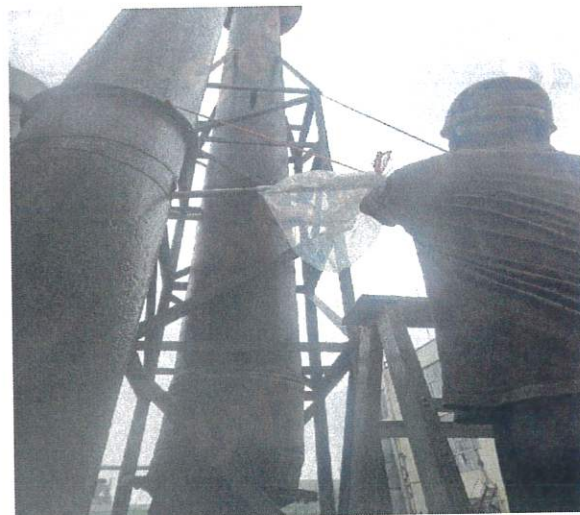
DA045 安乃近成品烘干废气排放口
