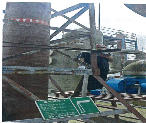
DA034 四车间综合废气排放口
