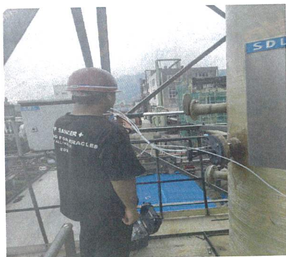
DA041 安乃近车间综合废气排放口
